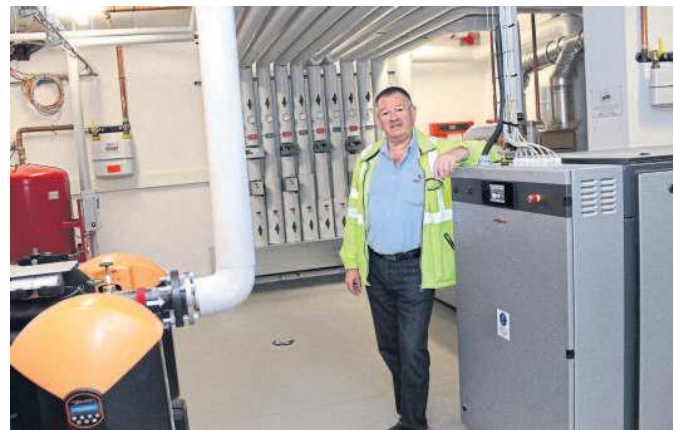
Im Bild SGB-Gesellschafter Eckhard Müller am Blockheizkraftwerk in der Heizzentrale der DRK-Senioren- und Pflegeeinrichtung Büdingen.
